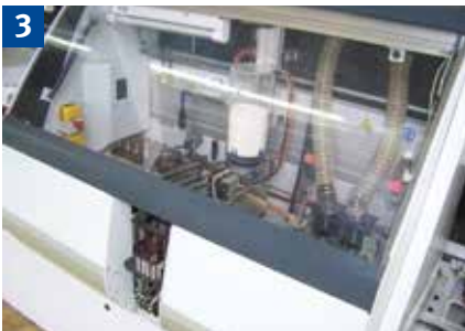
Sind die Gefahrstellen der Stachelwalze gesichert, z.B. mit einer elektrisch verriegelten Schutzhaube oder durch eine fest verschraubte Verkleidung?
