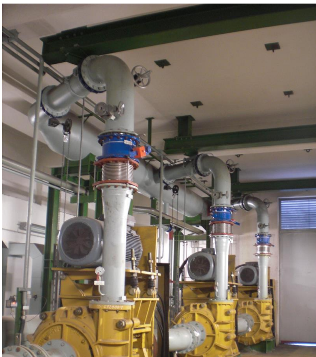
Bild 1: Ausbauträger in Pumpenstation
