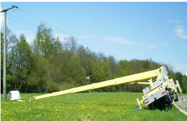
Bild 1: Umgestürzte FHAB durch zu geringe Bodentragfähigkeit
