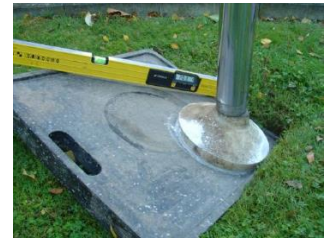
Bild 7: Außermittige Auflage erzeugt Kippmoment der Unterlegplatte! Keine gleichmäßige Lastverteilung! Gefahr des Einsinkens in den Untergrund!
