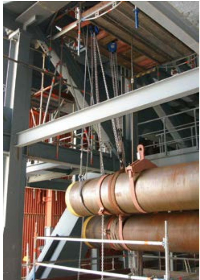
Bild 1: Abhängungen von Großrohrleitungen im Kraftwerksbau
