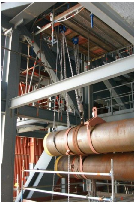
Bild 1: Abhängungen von Großrohrleitungen im Kraftwerksbau
