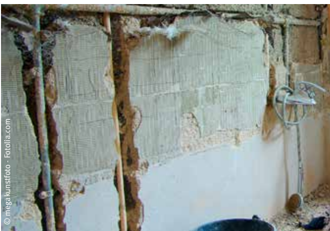
Putze, Spachtelmassen und Fliesenkleber in Altbauten können Asbest enthalten. Stemm- und Schlitzarbeiten an Wänden bergen die Gefahr einer Asbestexposition.
