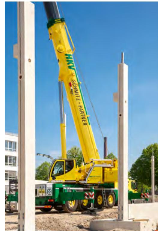
Die Position des Krans ist essenziell für sicheres Arbeiten. Unter anderem darf er nicht zu nah an der Kante der Baugrube stehen.
