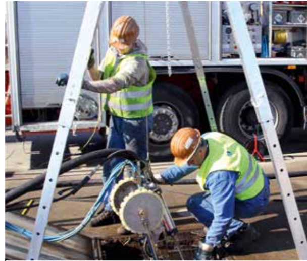
Mit dem explosionsgeschützten Tankreinigungsroboter „T-Rex“ der HWT GmbH werden Gefahren bei der Tankreinigung verhindert.
