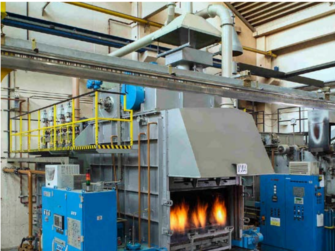
Abb. 17 Absaugungen an einem Mehrzweckkammerofen
