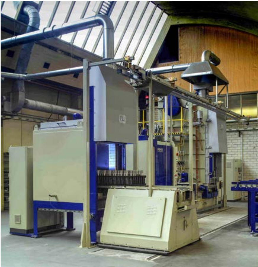
Abb. 36 Mehrzweckkammerofenlinie mit Anlassofen, Waschanlage und Mehrzweckkammerofen
