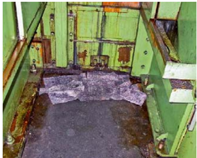
Abb. 4 Erhöhte Brandlast durch ölgetränkte Putztücher
