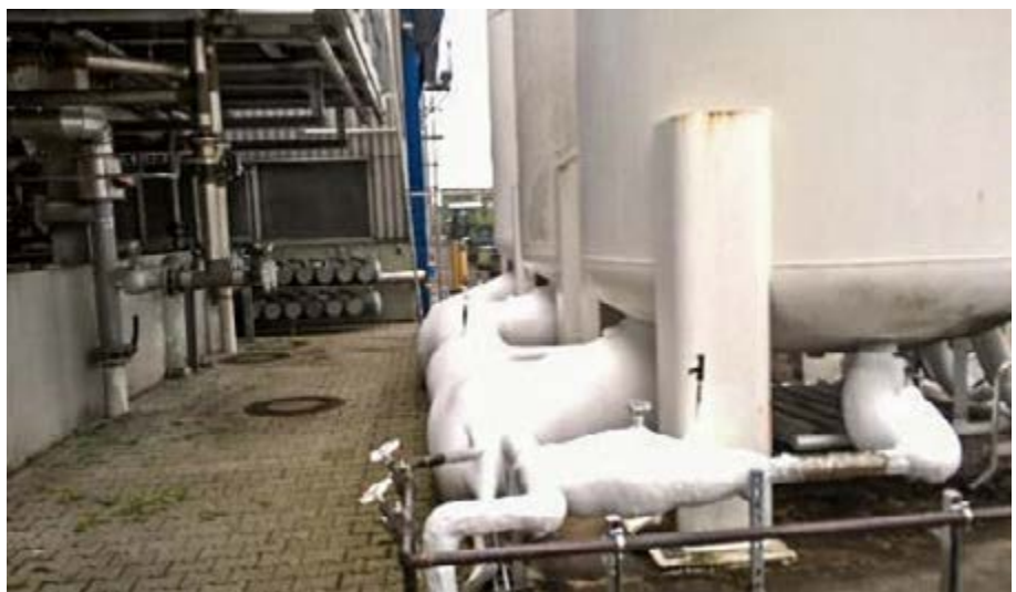
Abb. 31 Eisbildung an Rohrleitungen von Stickstofftanks
