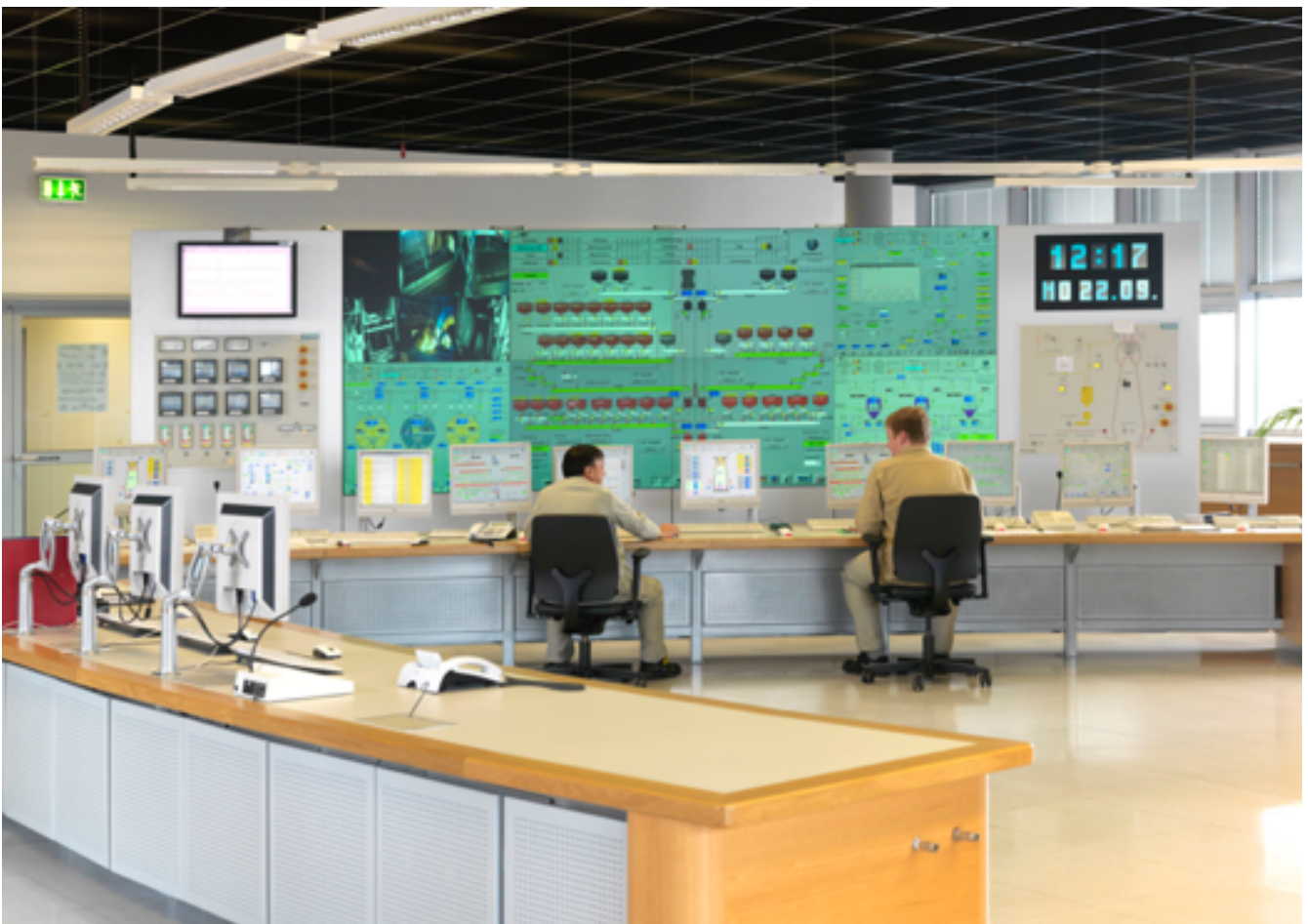
Bild 3 Moderner Leitstand einer komplexen Anlage der Hüttenindustrie
