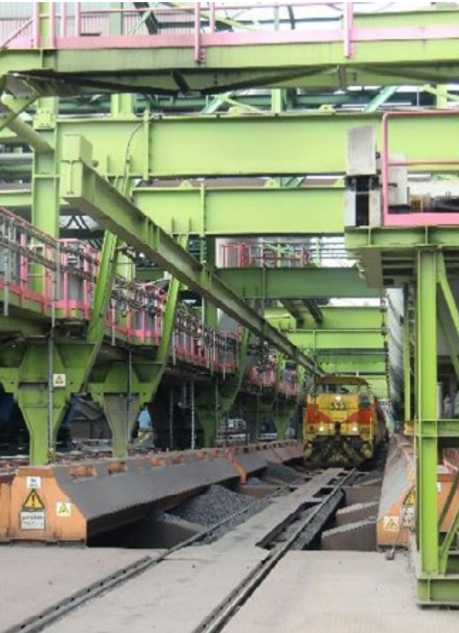
Bild 16 Bunkeranlage für Erz und Zuschlagsstoffe
