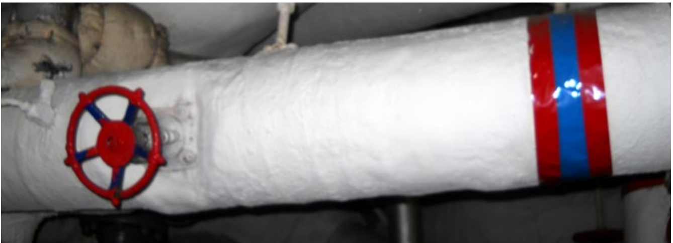
Abb.57 Rohrleitung mit asbesthaltiger Isolierung
