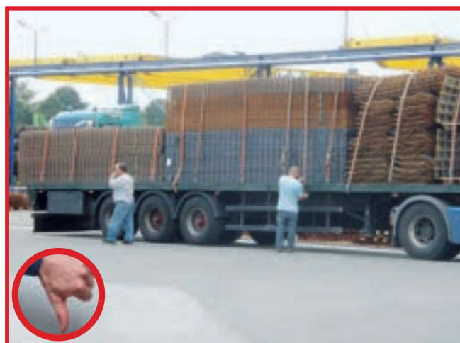
Abb. 10-80 Betonstahlmatten auf diese Weise nicht gesichert
