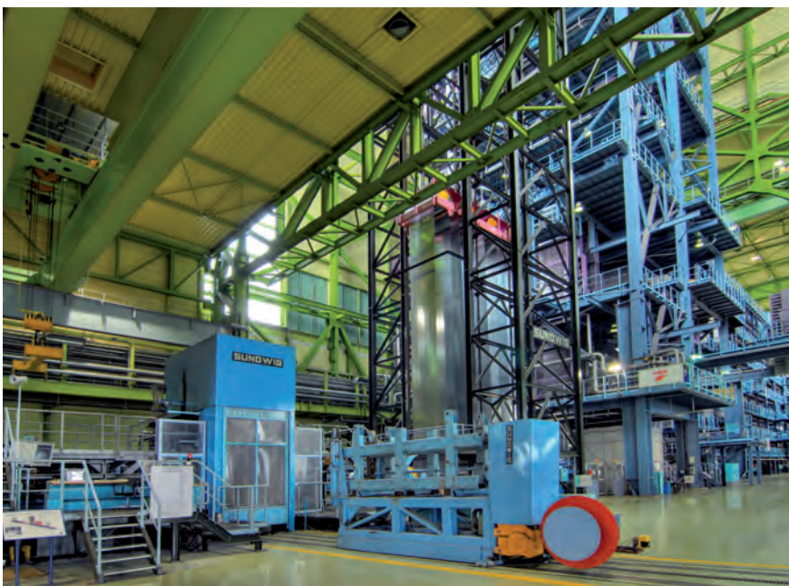
Bild 4-18: Beispiel für die Farbgestaltung der Feuerbeschichtungsanlage FB8 in Duisburg gestaltet durch das Studio von Garnier
