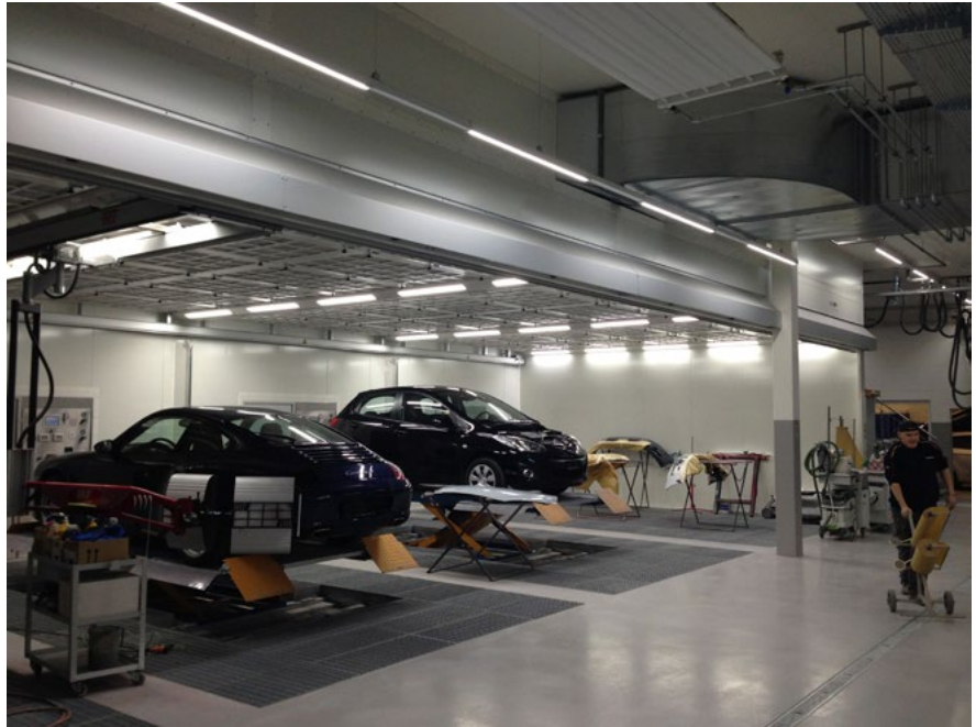
Abb. 3 Vorbereitungsplätze mit vertikal angeordneter technischer Lüftung: Zuluft von oben, Absaugung im Boden
