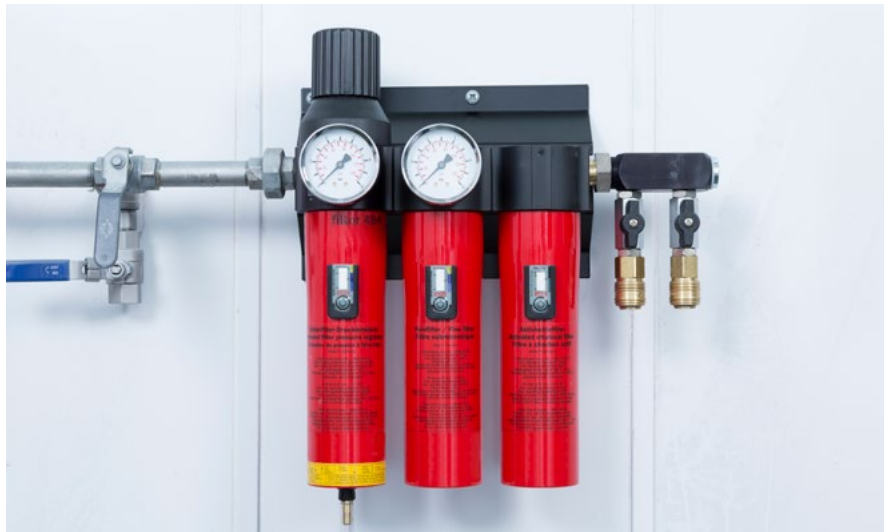
Abb. 13 Druckluft-Aufbereitung für fremdbelüftete Atemschutzgeräte mit Filterpatronenstandzeitanzeige
