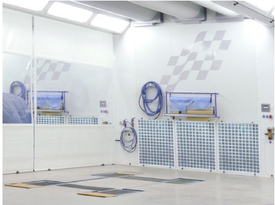
Abb. 5 Vorbereitungsplatz mit diagonaler Luftführung (senkrechte wandseitige Absaugung)
