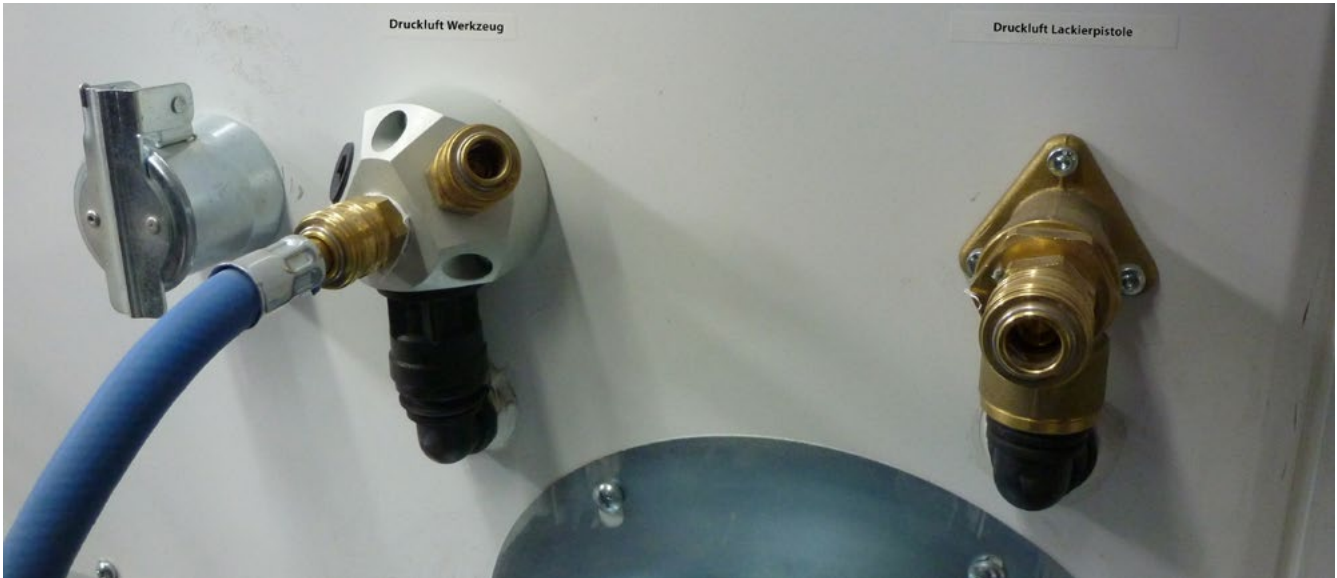
Abb. 9 Separate Druckluftversorgung für Handwerkzeuge und Lackierpistolen
