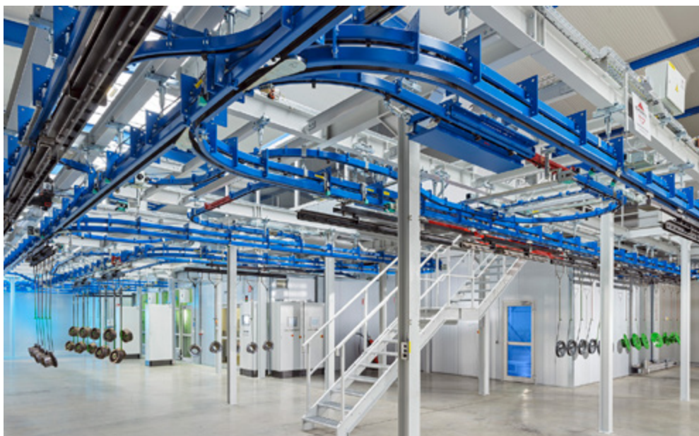
Abb. 3: Integration einer komplexen Lackieranlage in ein Gebäude
