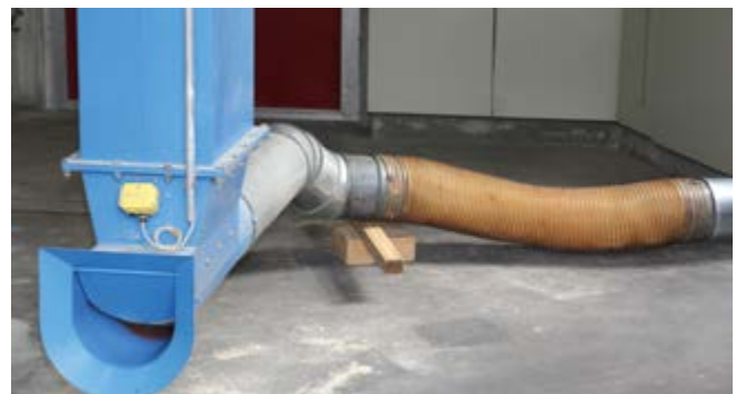
Abb. 7.6 und 7.7 Austrageeinrichtung mit 2 Ausfallstützen zum wahlweisen Späne-Transport in eine Heizungsanlage (7.6 oben) oder eine externe Transportanlage/Späne-Entsorgung (7.7 unten)
