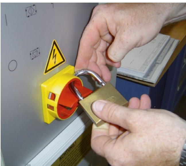
Abb. 58 Elektrische Energietrenneinrichtung [H]
