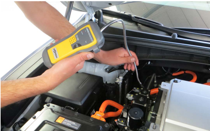
Abb. 13 Im Rahmen einer Ausgangsprüfung können auch mobile Lecktester bei der Prüfung wasserstoffführender Leitungen eingesetzt werden.
