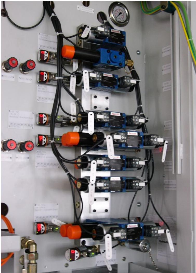
Abb. 20 Kennzeichnung von Hydraulikventilblöcken
