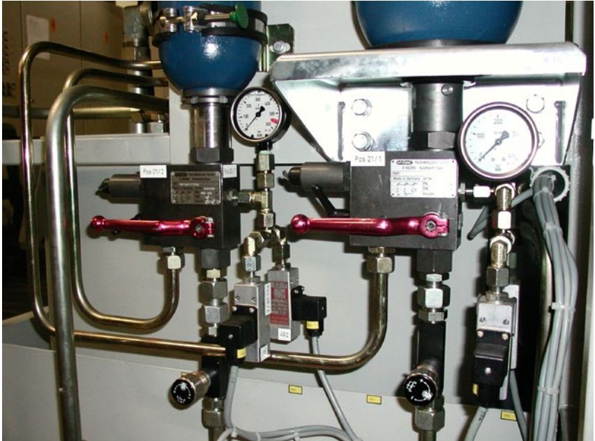
Abb. 25 Druckentlastete Hydrospeicher mit abgesperrten Druckleitungen
