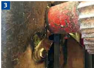
Sicherung der oberen Druckwalze gegen Absinken durch eingeschwenkte mechanische Sperre
