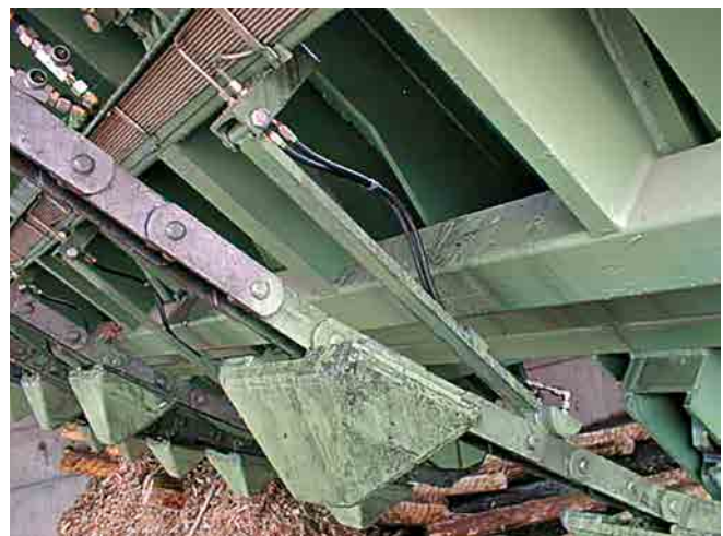
Abb. 38 Zentralschmierung am rücklaufenden Kettenstrang eines Vereinzlers einer Zugangstür
