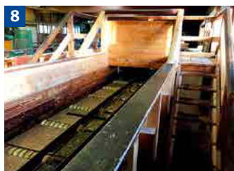
Fördereinrichtung mit sicherem Übergang
