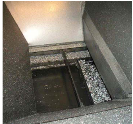
Bild 32 Späneförderer als Absaugstelle
