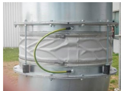
Abb. 31 Kompensator in einer Absauganlage
