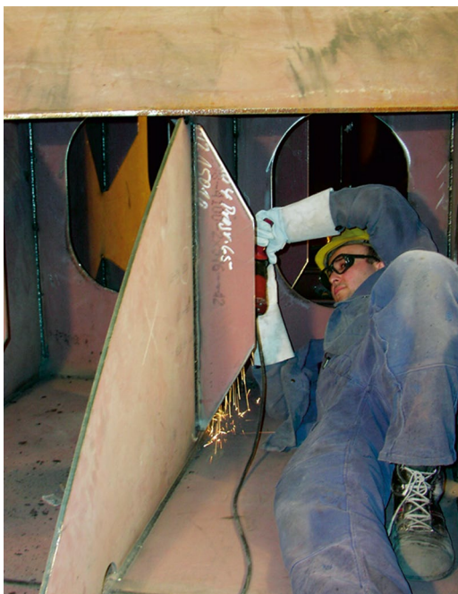
Abb. 9-1 Enger Raum mit erhöhter elektrischer Gefährdung
