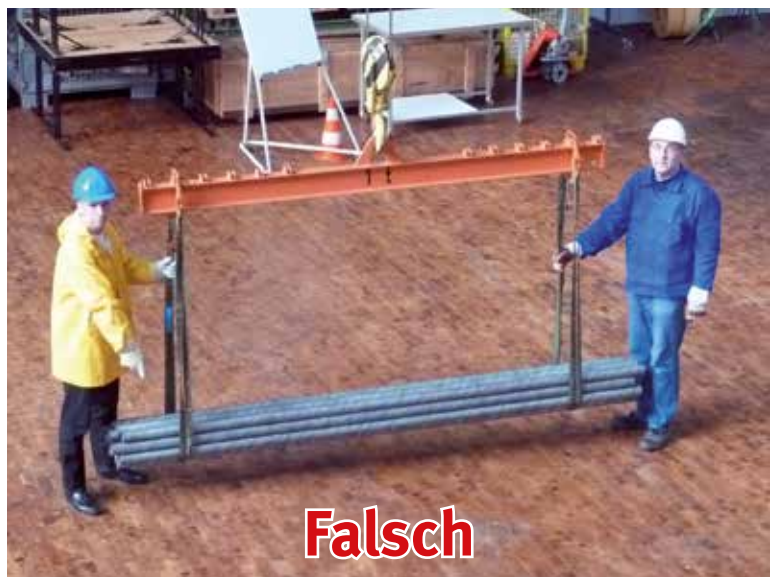
Bild 5-15: Beine der Anschläger befinden sich im Gefahrenbereich
