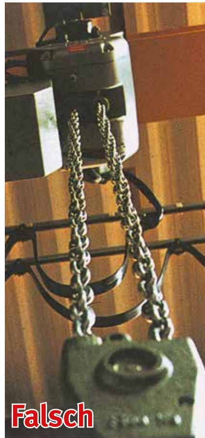
Bild 4-12: Ein Blick in Längsrichtung der hängenden Hubkette genügt, um festzustellen, dass die Kette verdreht ist
