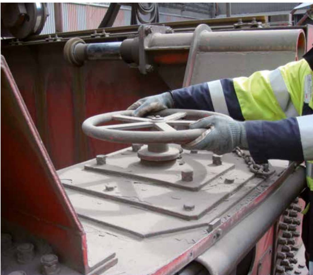
Bild 7-5: Der Kran- führer dreht die Schienenzange an. Diese Windsicherung kann an jeder Stelle der Kranbahn betätigt werden
