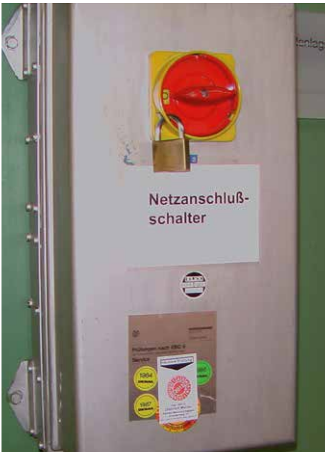
Bild 7-2: Der Kranführer schaltet den Netzanschlussschalter aus
