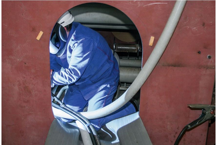
Abb. 5-1 Beispiel für erhöhte elektrische Gefährdung beim Schweißen
