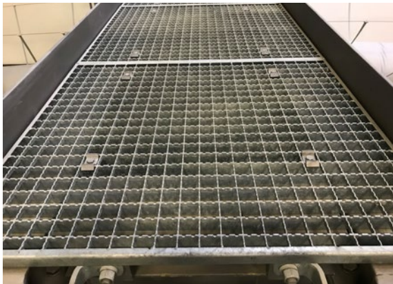
Abb. 2.3 Sicher befestigte Bodenroste
