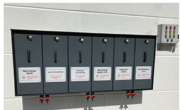
Abb. 8.4 Chemikalienbefüllstation für Tankware
