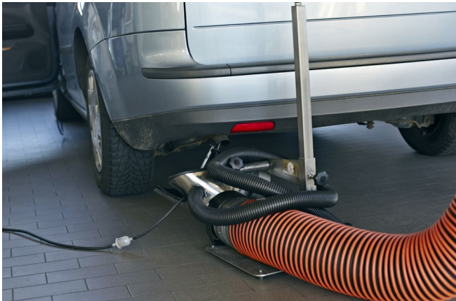
Abb. 17-1 Abgasabsaugung mit oberirdischer Anlage
