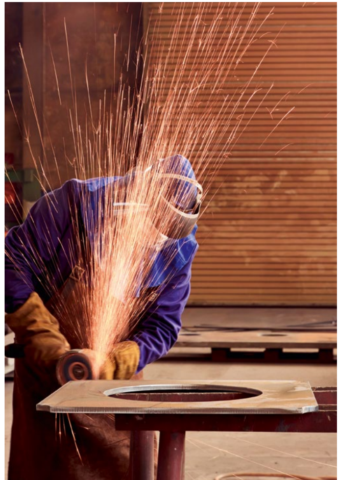
Abb. 24 Schleiffunken als Zündquelle
