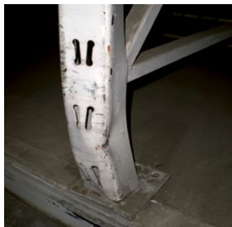
Abb. 12 Gerissene Schweißnaht an der Fußplatte der Stütze
