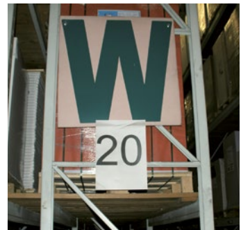
Abb. 15 zu tief eingelagerte Palette führt zu einer Überlastung der inneren Stützen und Trägern
