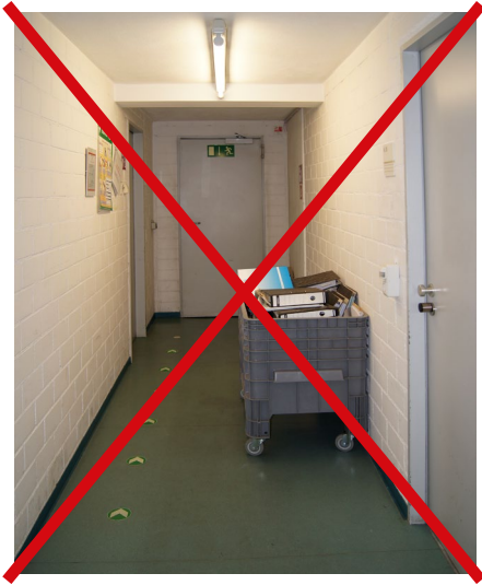
Abb. 17 Unzulässige Lagerung im Flucht- und Rettungsweg
