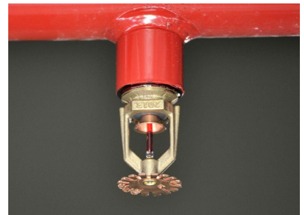
Abb. 58 Installierter Sprinkler im Rohrnetz
