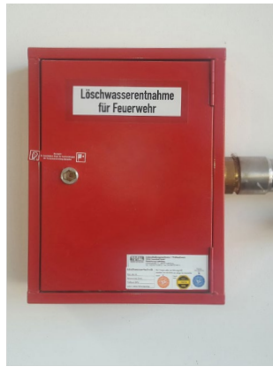
Abb. 64 Entnahmestelle einer trockenen Löschwasserleitung
