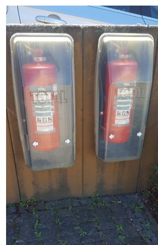
Abb. 51 Vor Witterungseinflüssen geschützte Feuerlöscher
