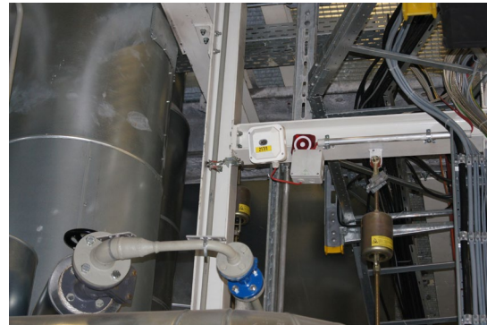
Abb. 34 Flammenmelder an einer Industrieanlage
