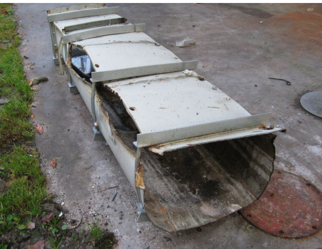
Abb. 29 Zerstörte Filterelemente (Quelle: BGN)
