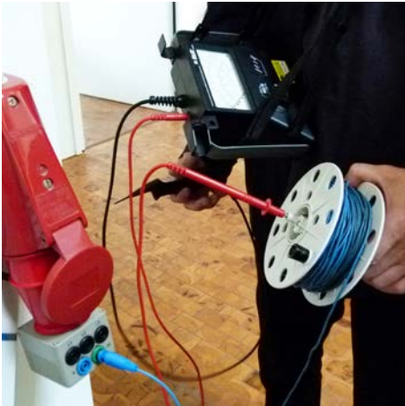
Abb. 8 Messung der niederohmigen Schutzleiterverbindung
