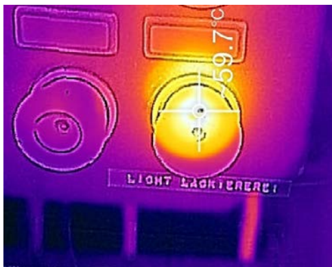
Abb. 24.2 Verteilung mit Diazed-Sicherungen; Thermographiebild
