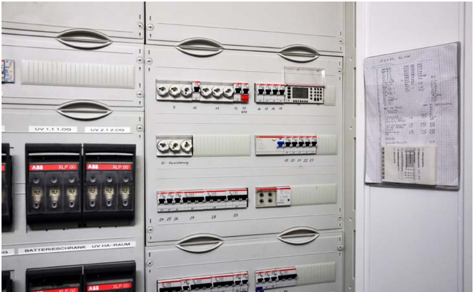
Abb. 4 Stromkreiskennzeichnung und zugehörige Dokumentationen einer elektrischen Unterverteilung
