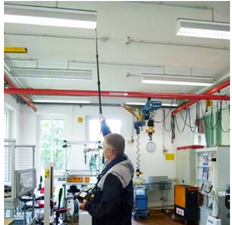
Abb. 9 Messung der niederohmigen Schutzleiterverbindung; Leuchte
