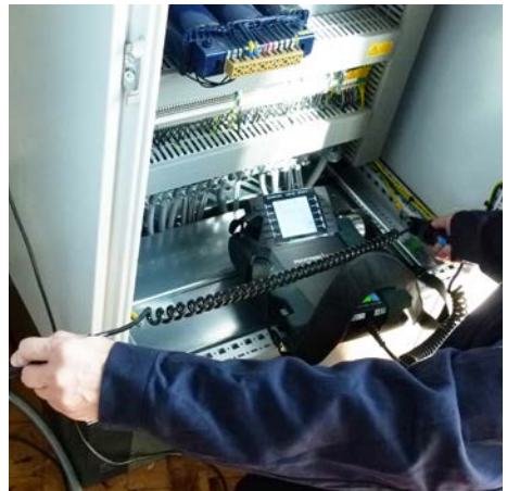
Abb. 11 Schutzleiterwiderstandsmessung; Messung der niederohmigen Schutzleiterverbindung; Schaltschrank
