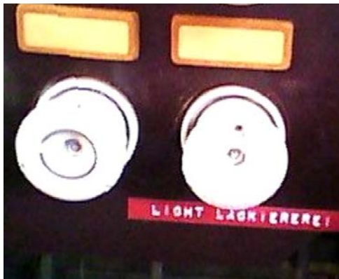
Abb. 24.1 Verteilung mit Diazed-Sicherungen
