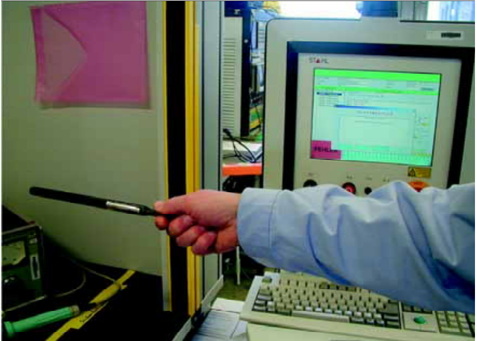
Bild 2: Funktionskontrolle der Sicherheitslichtschranke mittels Prüfstab
