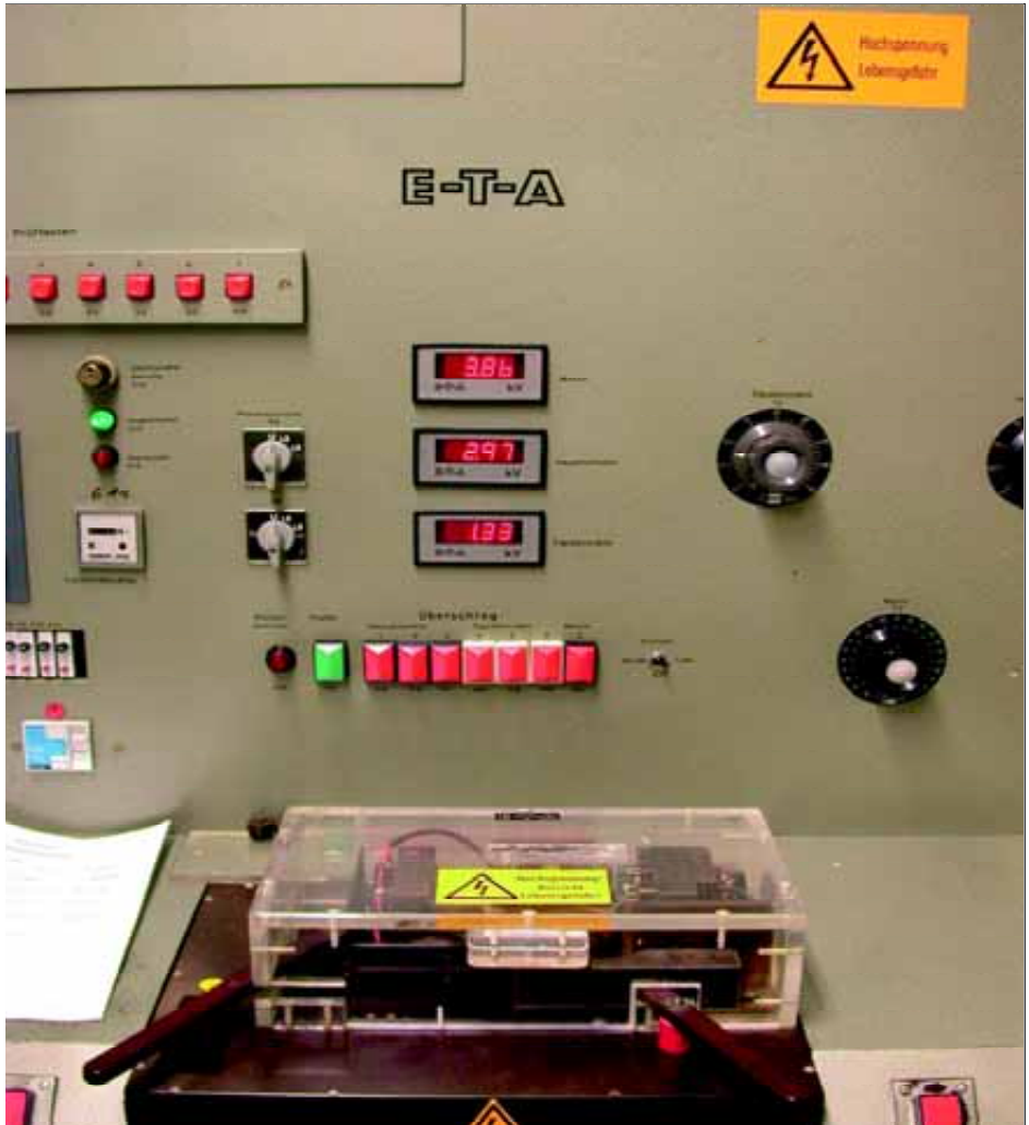
Bild 4: Prüfplatz mit zwangsläufigem Berührungsschutz, mechanische Verriegelung der Schutzhaube. Der Handhebel, der die Haube in Schutzstellung mechanisch verriegelt, ist mit Schaltkontakten belegt, die in den EIN- und AUS-Schaltvorgang integriert sind.
