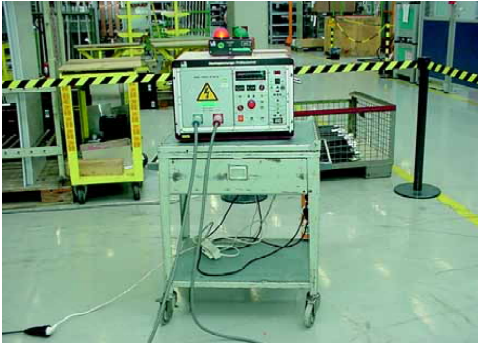
Bild 5: Durch Ausziehband abgegrenzter Prüfbereich für einen Prüfplatz ohne zwangsläufigen Berührungsschutz
