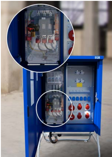
Abb. 9 Baustromverteiler mit Festanschluss
