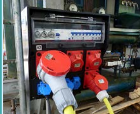
Stromverteiler mit Steckdosen (stationär)
