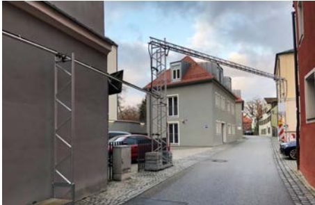
Abb. 1 Hochgelegte Leitung zur Straßenquerung (Kabelbrücke)
