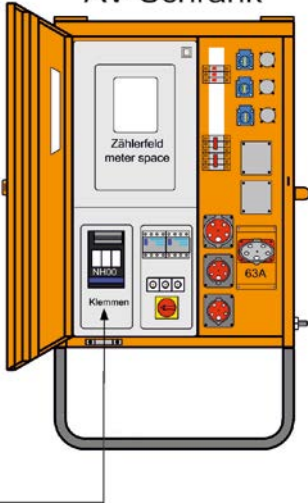
Abb. 3 Versorgung einer kleineren Baustelle mit nur einem Anschlussverteiler-Schrank
