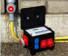
Stromverteiler mit Steckdosen (mobil)
