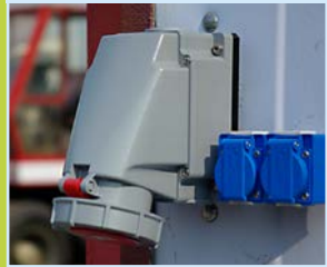
Steckdosen (unbekannte Schutzmaßnahme)
