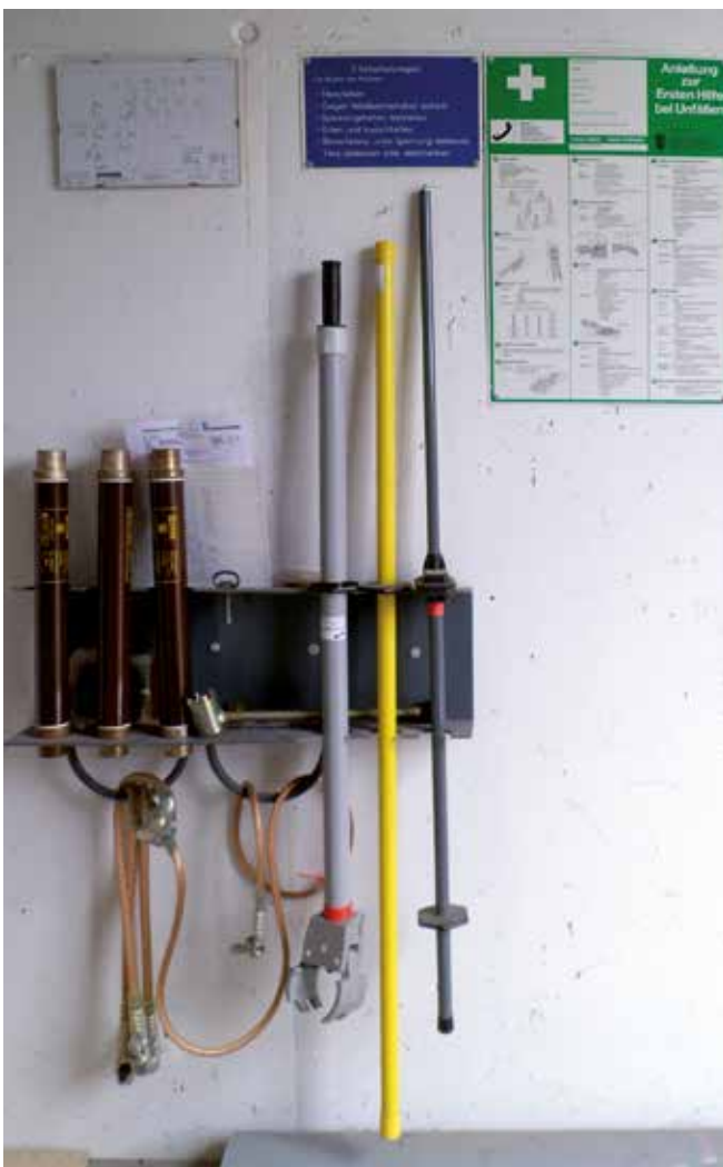
Bild 5-1: Einrichtungen für sicheres Arbeiten in elektrischen Anlagen sind bereitzustellen und zu benutzen
