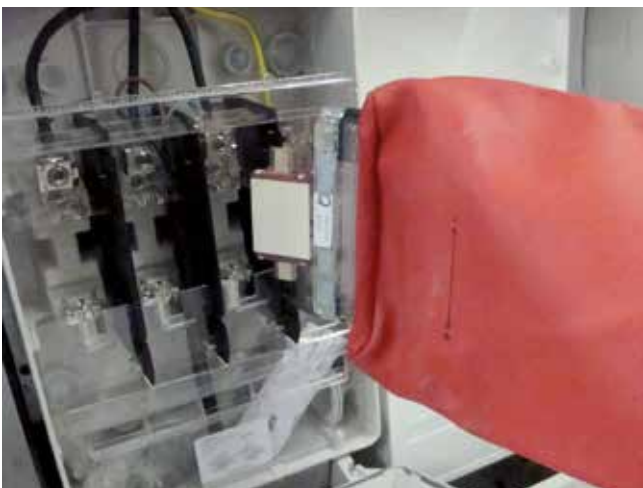
Bild 5-7: Herausnehmen eines NH-Sicherungssatzes
