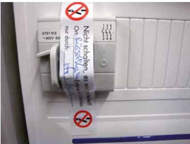
Bild 5-11: Gegen Wiedereinschalten gesicherter Hauptschalter
