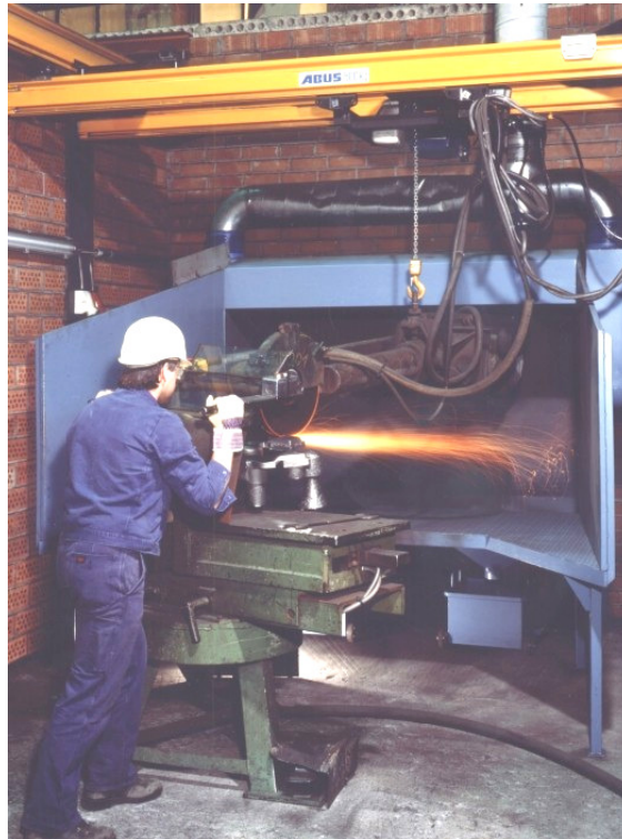
Abbildung 7: Wirbelzylinder als Schleifplatzabsaugung an einer Pendelschleifmaschine (Quelle: Kessler + Luch Entwicklungs- und Ingenieurgesellschaft, Gießen)
