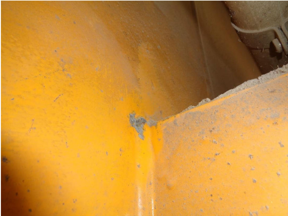
Abbildung 5 Sichtprüfung Verdachtsstelle abgeblätterte Beschichtung
