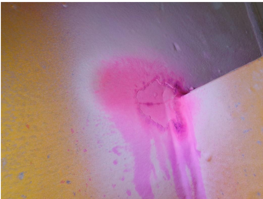
Abbildung 7 Darstellung des Risses durch PT-Prüfung
