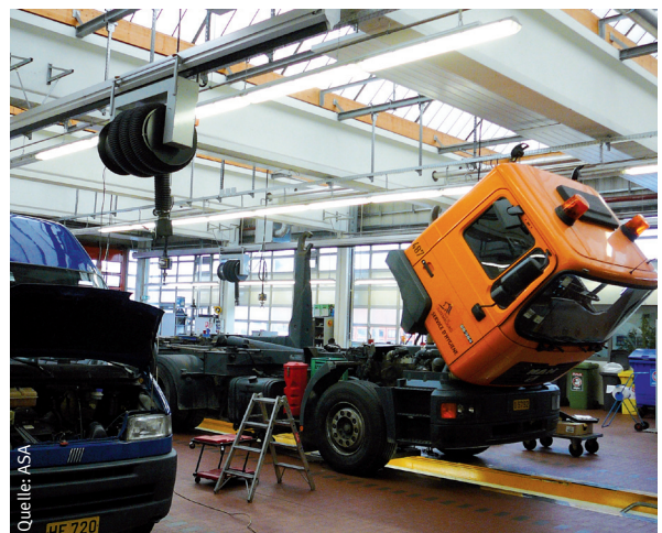
Bild rechts: Saugschlitzkanal-Anlage in der Lkw-Werkstatt
