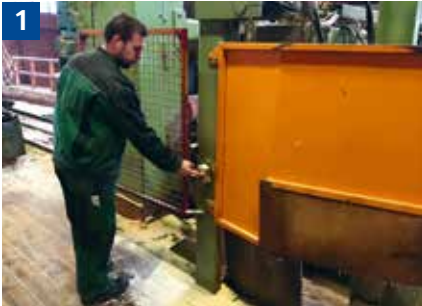
1 Trennende Schutzeinrichtungen mit Verriegelungseinrichtung
