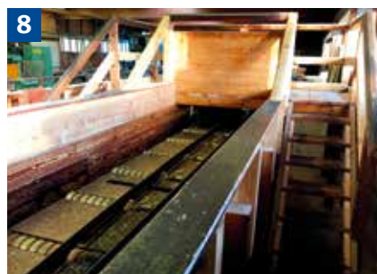
8 Fördereinrichtung mit sicherem Übergang
