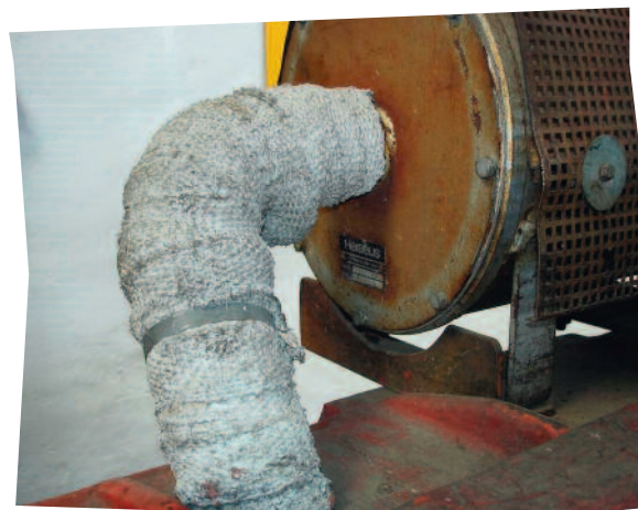
Abgaskrümmer mit Asbestband.
