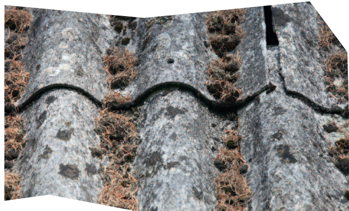
Ebene oder wellige, meist graue Asbestzementplatten als Bedachung, Wand, Balkonbrüstung, Fassaden- oder Dachüberstandverkleidung an Häusern, alten Industrie- und Lagerhallen, Scheunen, Stallgebäuden, Garagen, Gartenlauben und Schuppen.
